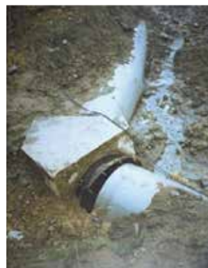
写真-1 曲管周辺での継手の離脱
