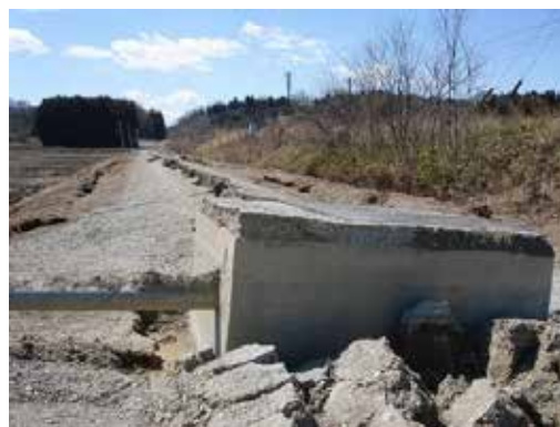
写真-2 液状化に伴う構造物の浮上
